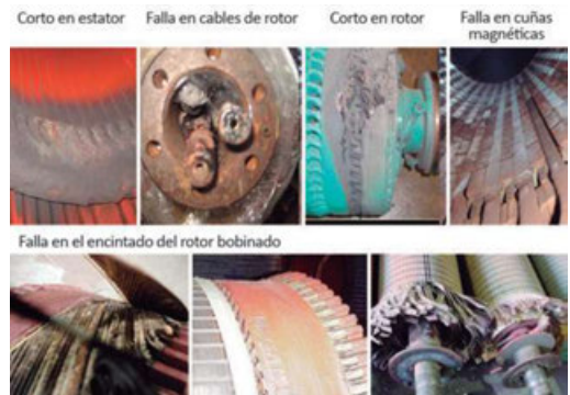
Figura 4. Fallas eléctricas en aerogeneradores.
